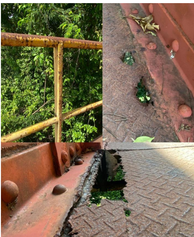
Figura 6, 7 e 8: Corrosão por pites, no corrimão e chapas do piso da passarela de pedestres da Ponte Metálica Benedito Leite.
