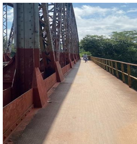
Figura 3: Corrosão por manchas no piso da passarela da ponte.
