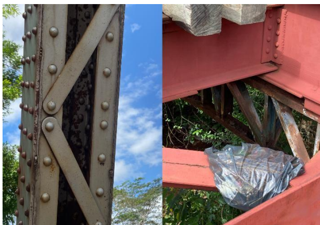
Figura 4 e 5: Corrosão irregular nos rebites e internamente às treliças da Ponte Metálica Benedito Leite, Caxias–MA.
